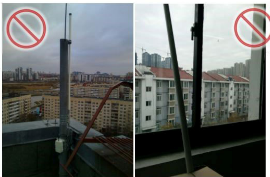
Ошибка! Мачта и молниеотвод закрывают антенну, антенна слишком низко над парапетом (слева); антенна установлена в квартире жилого дома (справа).
